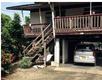
44 Slecht onderhouden gevel
